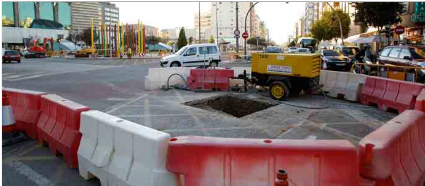
Los operarios trabajan estos días en las obras de electrificación en el cruce de Paseo Morella con avenida Barcelona para reforzar la catenaria. EUGENIO TORRES
